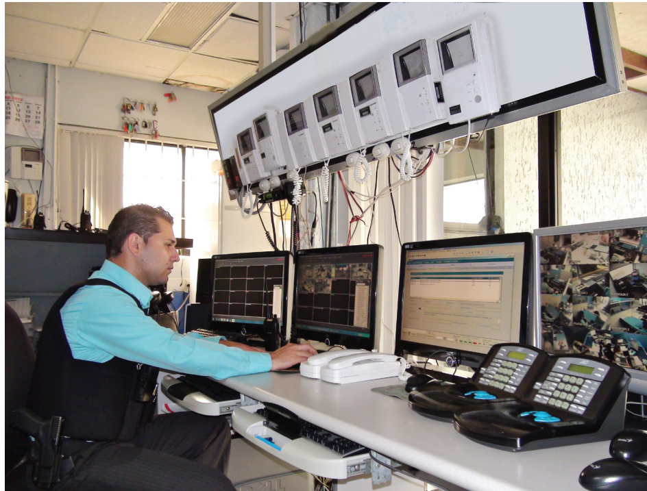
Centro de Monitoreo, Oficinas Centrales
